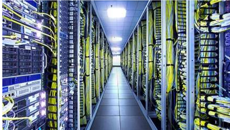
Data center [ ABB ]
